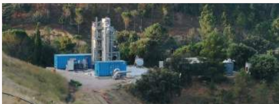
Evapo Concentrateur et chaudière à biogaz
