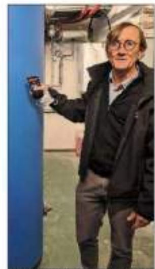
Raphaël Petit, dirigeant de E 2 solaire, devant le ballon d'eau chauffé par les panneaux solaires, dont il est l'installateur.
